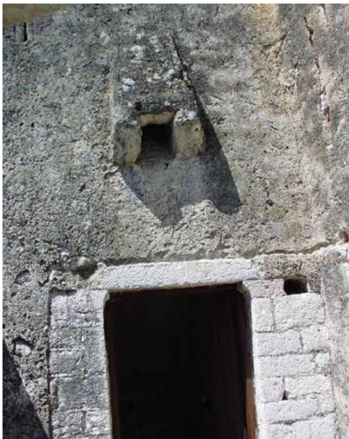
Η καταχύστρα (λαδορίχτης) πάνω από την είσοδο του πύργου. / The hopper shaped opening above the entrance of the tower.
